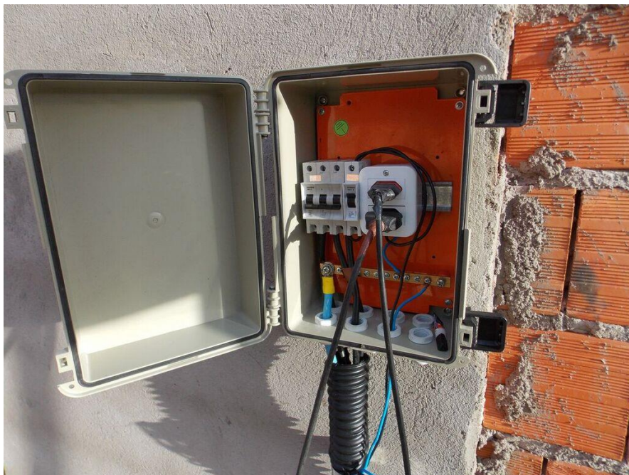
Figura 37 - Quadro de distribuição.
