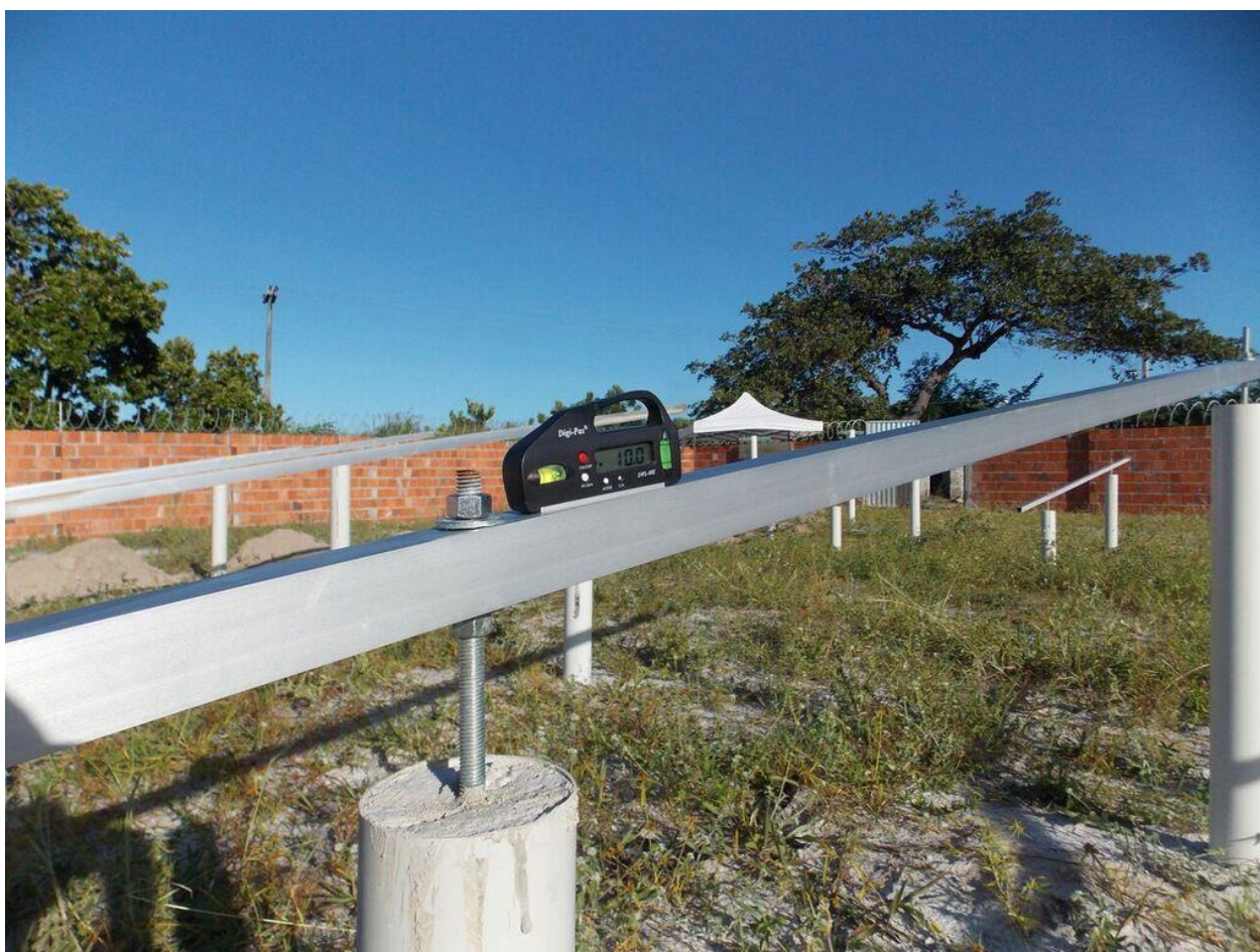
Figura 40 - Diferença de nível do perfil metálico em relação às barras roscadas.
