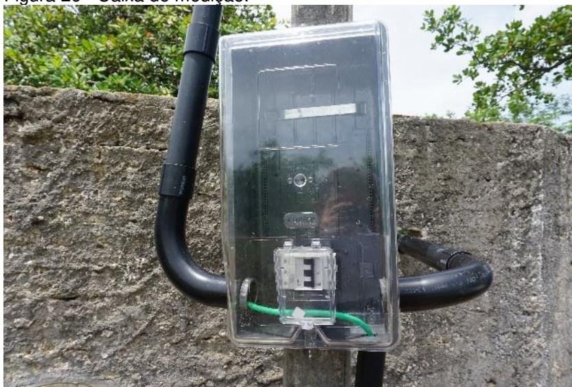
Figura 26 - Caixa de medição.
