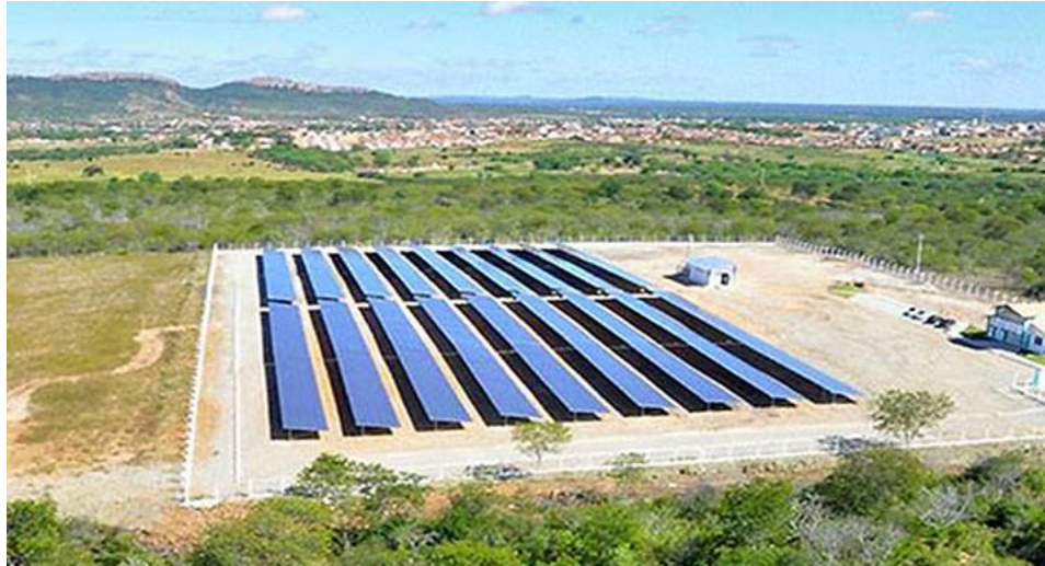
Figura 6 - Usina solar FV em estrutura no solo.
