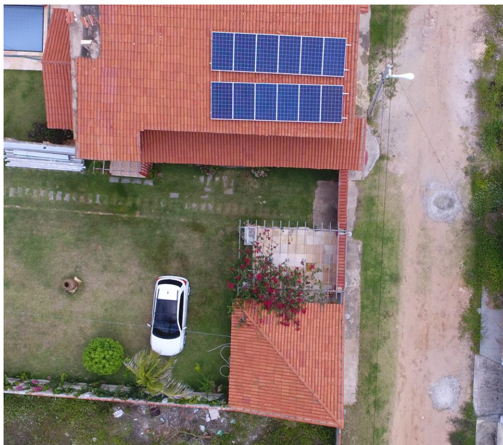
Figura 5 - Sistema FV de 3,84 kWp instalado em telhado no litoral do Ceará.
