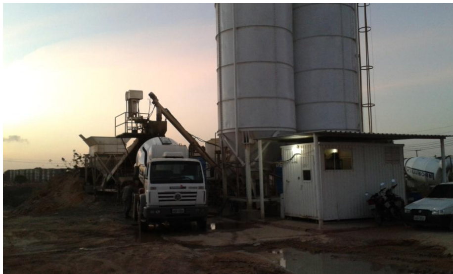
Figura 5 – Mini usina da Labormix no canteiro de obra da Fujita Engenharia.
