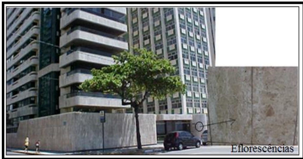
Figura BV 7.2 - Eflorescências em revestimento de fachadas de edifício com placas de Calcário Bege Bahia, litoral do Recife, Pernambuco, Brasil.
