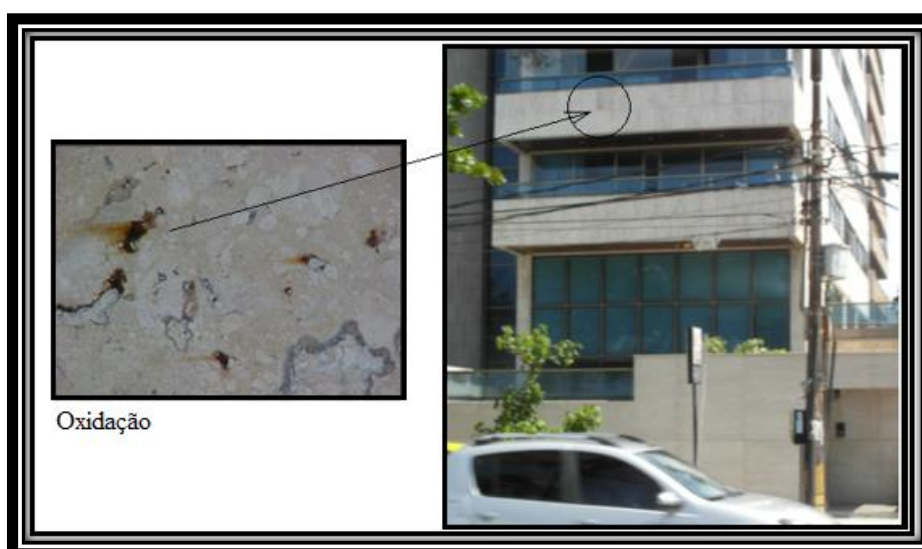
Figura BV 7.8 - Presença de manchas ou nódulos acastanhados, marrons ou avermelhados no revestimento de fachadas de edifício com placas de Calcário BB, litoral do Recife-PE, Brasil.
