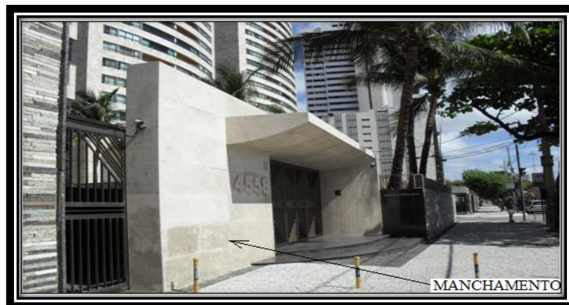
Figura BV 7.1 - Manchamentos em revestimento de coluna de edifício com placas de Calcário Bege Bahia, litoral do Recife-PE, Brasil.
