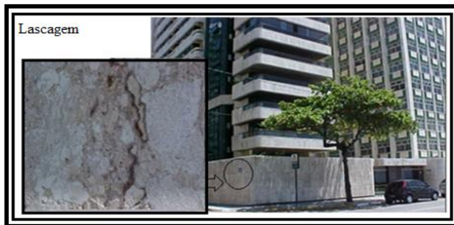
Figura BV 7.5 - Lascagem em revestimento de fachadas de edifício com placas de Calcário Bege Bahia, litoral do Recife, Pernambuco, Brasil.
