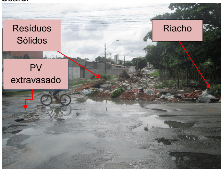
Figura 1 – Resíduos sólidos e poço de visita extravasado no entorno do riacho Maceió, Fortaleza, Ceará.
