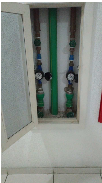
Figura 9 - Vista da instalação do hidrômetro individualizado do Condomínio B
