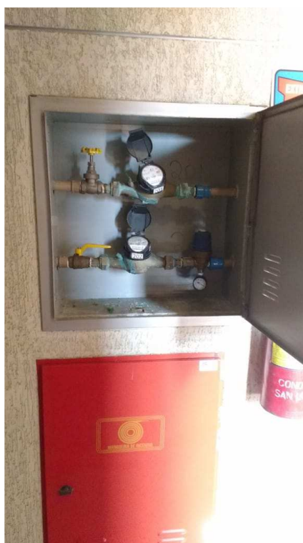
Figura 12 - Vista da instalação do hidrômetro individualizado do Condomínio C
