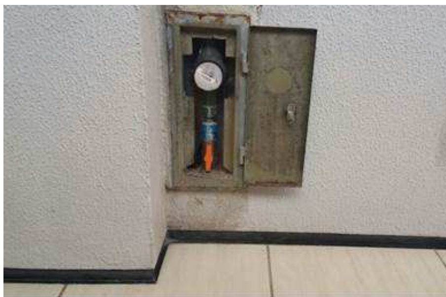
Figura 6 – Vista da instalação do hidrômetro individualizado do Condomínio A
