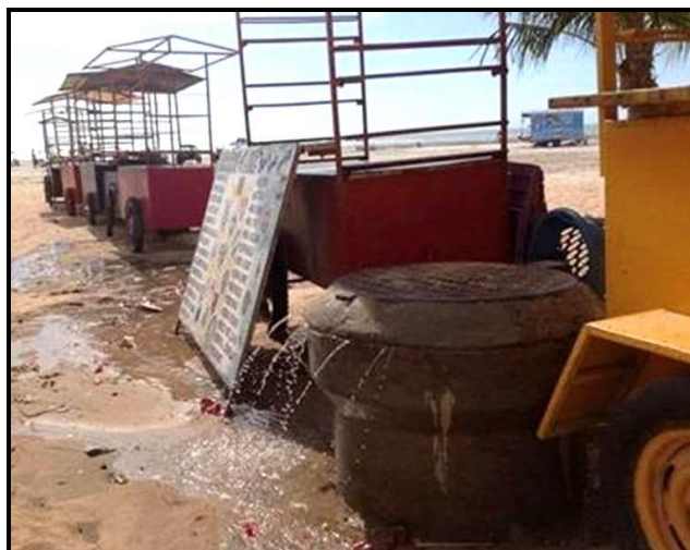
Figura 17 - Estação elevatória com vazamento de esgoto diretamente na rua.
