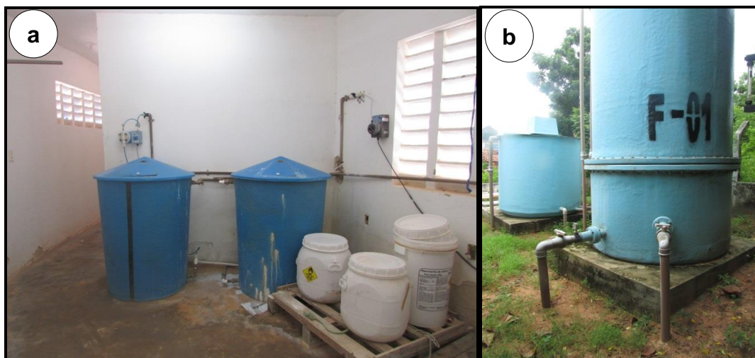
Figura 13 - Tratamento de água da vila de Jericoacoara. (a) tratamento por hipoclorito de cálcio- Ativa, (b) tratamento bacteriológico- desativado.
